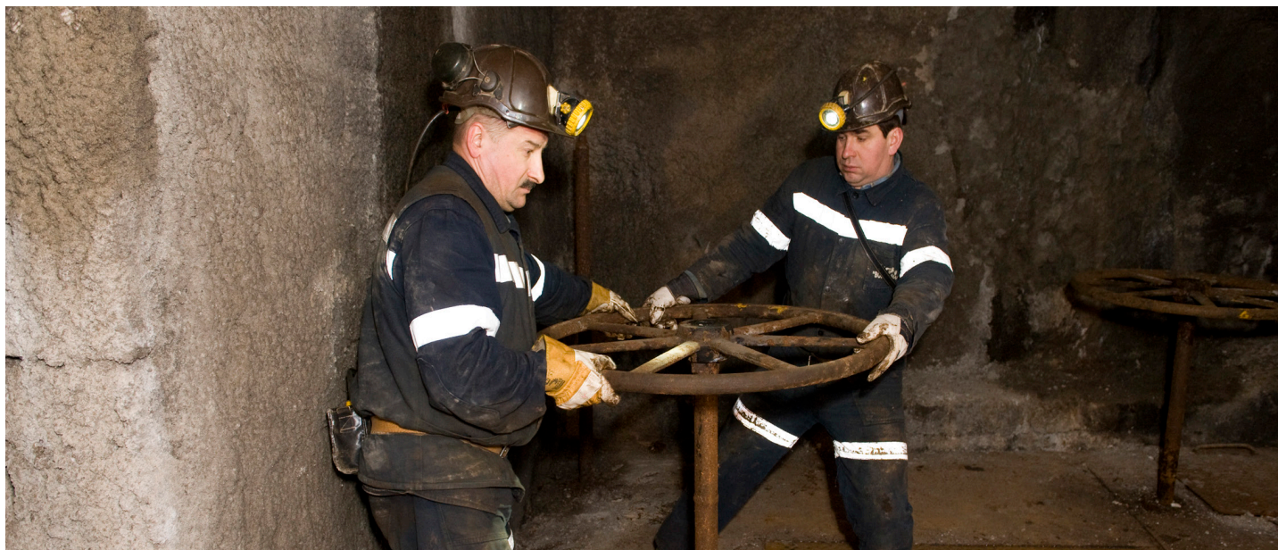
Pokrętła do opuszczania i podnoszenia zasuw w zabudowanej w chodniku wodnym tamie korek (fot. Krzysztof Boniecki)
