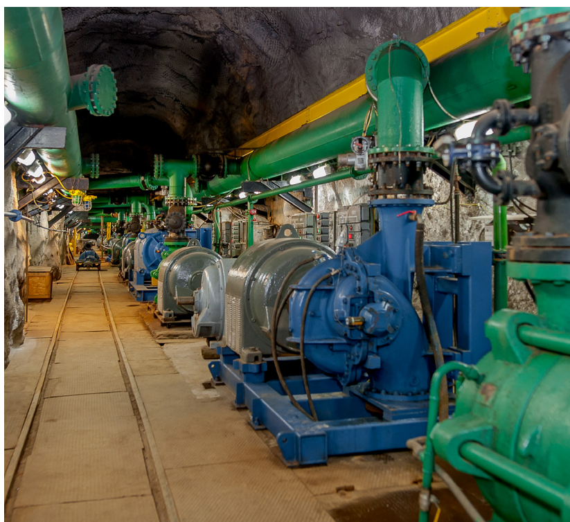
Pompa Weir Pumps na stanowisku pompowym (fot. Krzysztof Boniecki)
